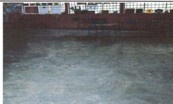
Foto 2: Piso de cemento líquido se quiere mejorar con piso de granito en 2 salones de clase.
