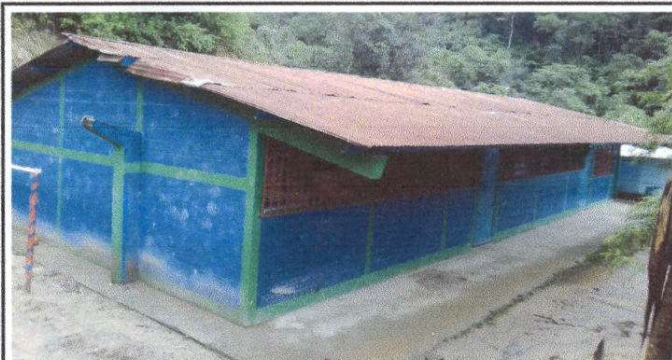
Foto 1: Lámina de techo de la escuela en mal estado por orificios donde se cuela el agua.
