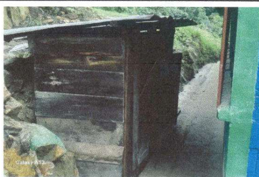
Foto 4: Es necesario quitar puertas de madera en baños por puertas de metal.
